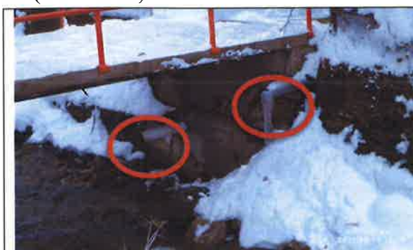
Direktni ispust kanalizacije u r.Borovicu (D.Borovica)
